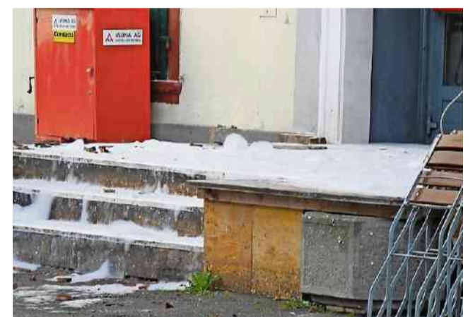
Schaumrückstände nach dem Löschangriff der Feuerwehr.
